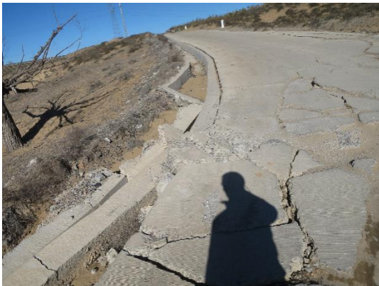
照片 3.3-1 219 工作面道路裂缝（镜向 NW）
