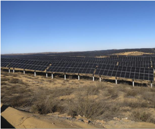
照片 2.6-3 隆武光伏发电项目 1
