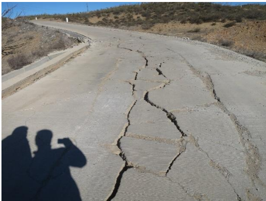
照片 3.2-1 损毁乡村道路（镜向 NE）
