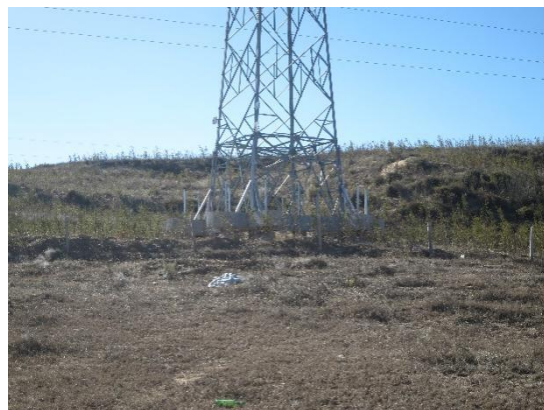
照片 3.2-2 高压线塔破坏（镜向 NE）
