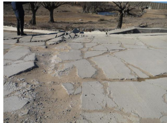
照片 3.3-4 道路裂缝（镜向 SE）
