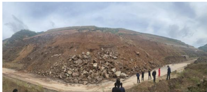
图6 志丹-南梁红色旅游公路局部发生滑坡
