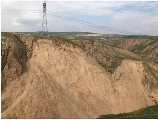
图3 定边县某±800 kV 输电线路塔基斜坡发生滑塌
